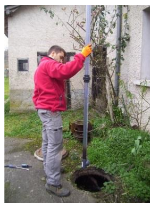
Mesure de boues d'une fosse septique
